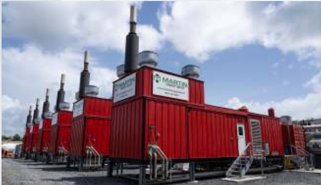
Planta de embotellamiento- 6.6 MW – Propano
